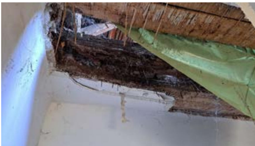
Poškodovan strop zaradi zamakanja strehe Trg svobode 18
